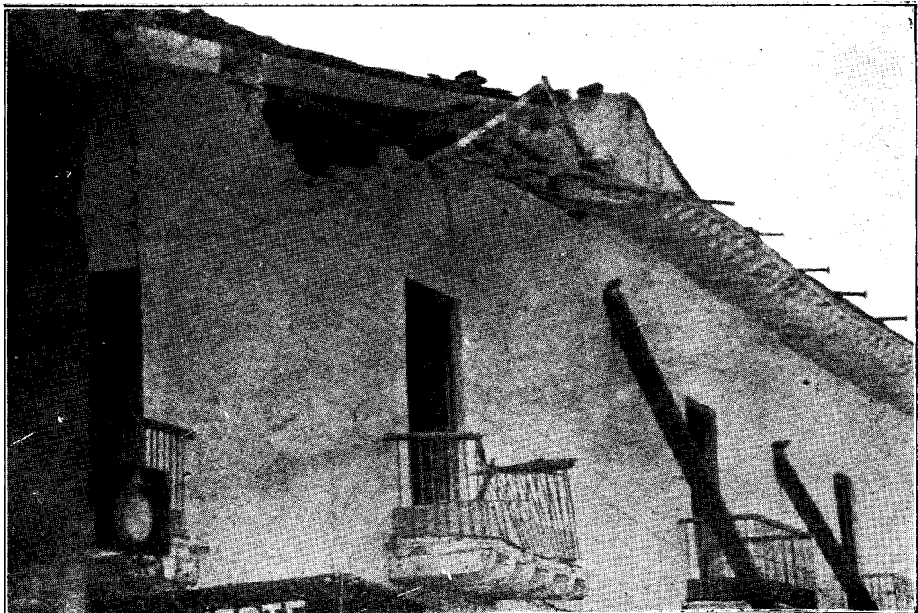
Fotografía número 2.—Detalle de las destrucciones en la fachada de la casa situada en la esquina de la 11.ª calle de Zamora y de la calle de Alba, Jalapa, Ver.
