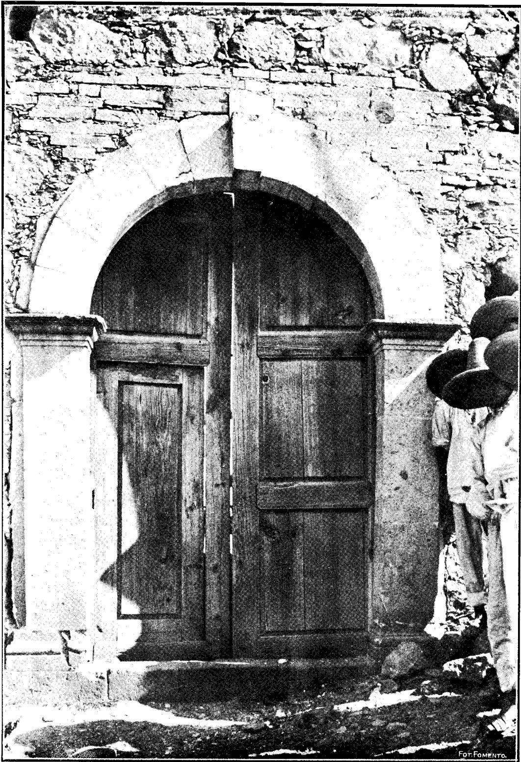
Fig. 68.—Arco de entrada que ve al Poniente, en la capilla de Santa María Tixmadeje. Fractura de la base de la jamba del Norte.
