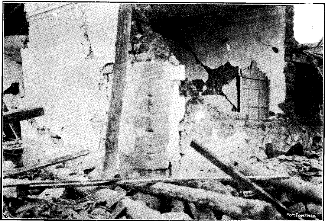
Fig. 61.—Casa de la esquina de las calles de Cuauhtémoc y 5 de Mayo. Se ve la caída del muro hacia el Norte y la dirección general de las cuarteaduras en los muros apañados de Norte a Sur.
